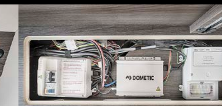
14 Moderne boardelektronica in de achterkant
